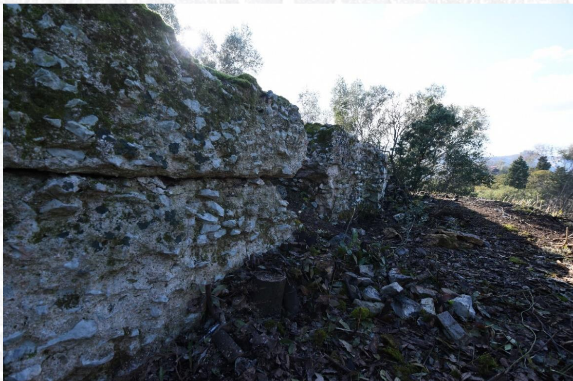
Urušeni duži zid/ The collapsed, longer wall
