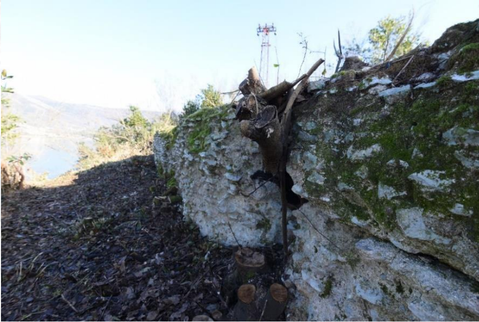
Devastacij zida / The wall devastation
